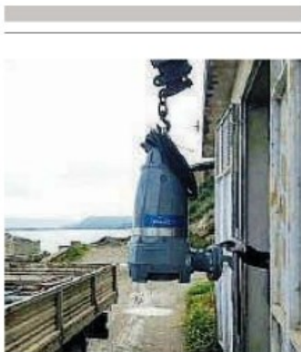
Lavori. La nuova elettropompa
